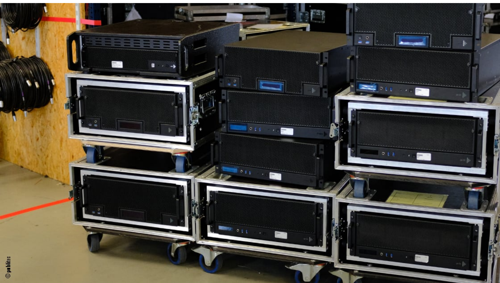
disguise Medienserver im publitec-Mietlager
